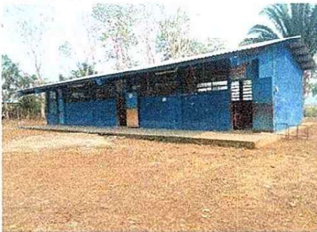
Foto 5: Pintura Exterior e interior en mal estado
