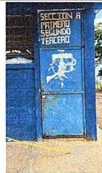
Foto 4: Sustrucción de puertas en mal estado
